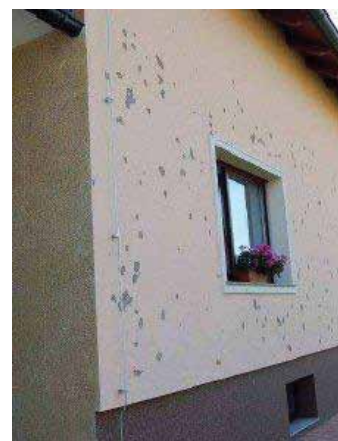
Fasáda poškodená krupobitím.
